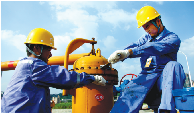
内江华润燃气有限公司城西储配站员工团结协作。
