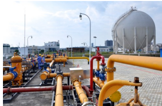
内江华润燃气有限公司城西储配站。
