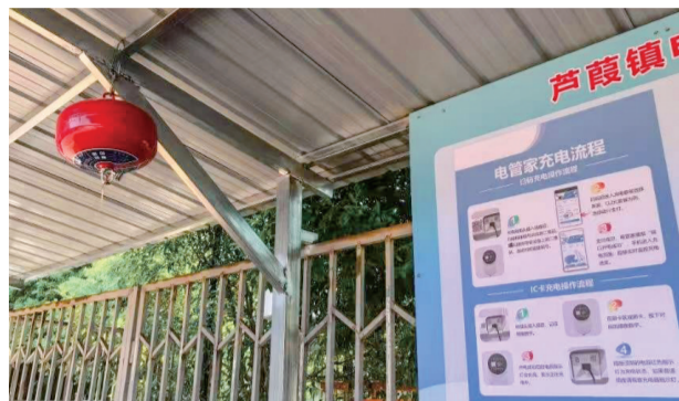
惠民电动车充电站。
