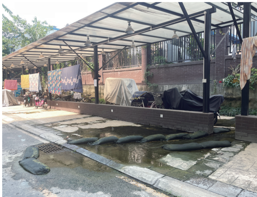
长廊区域在治理打造前污水横流。
