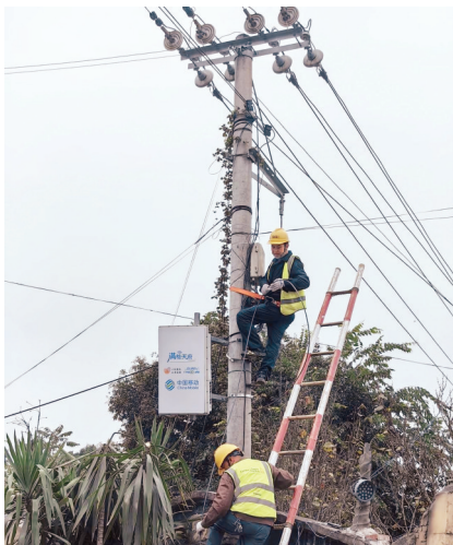
通信运营商安装临时设备解决网络拥塞。
