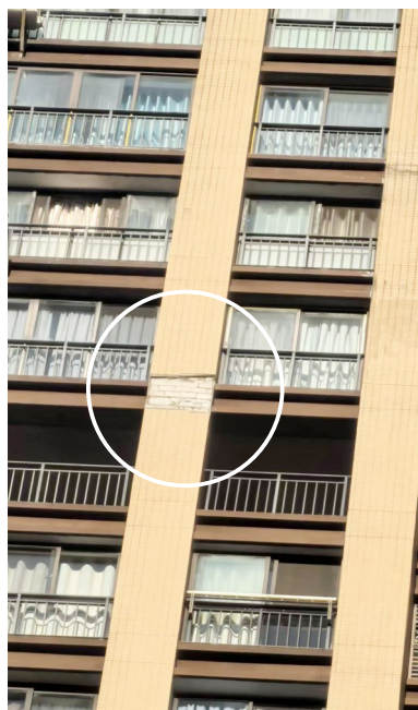
天和大院小区4栋2单元高处,一处外墙瓷砖明显脱落。
