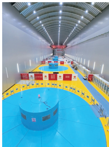
▲ 6月25日拍摄的大渡河双江口水电站内景。新华社发
