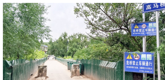
桥头立着禁止通行的标牌。
