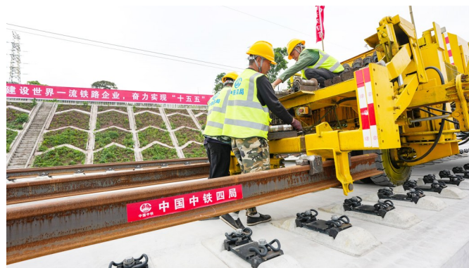
5月8日，在宜宾市渝昆高铁桥咀村特大桥梁施工现场，工人在进行铺轨作业。新华社记者 王曦 摄
