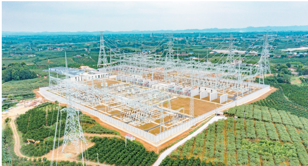
成都邛崃500千伏变电站全貌。王晨霖摄
