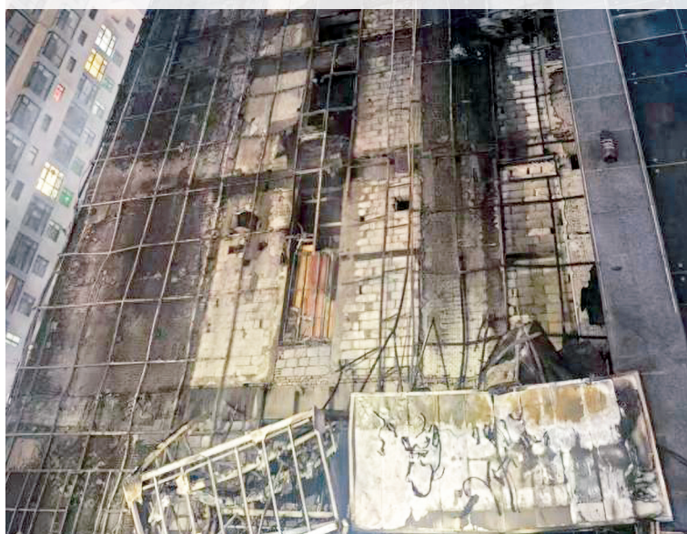
3月28日晚,太原市小店区亲贤北街附近一高层建筑发生火灾。图据新华社客户端
