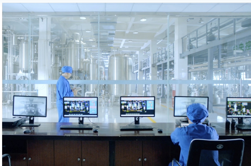
四川新绿色药业的中药配方颗粒生产车间中控室。
