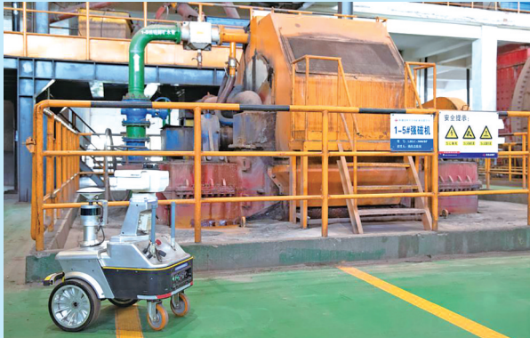
辽宁省鞍山市鞍钢集团关宝山矿业有限公司磨磁“黑灯工厂”内的智能巡检机器人。
