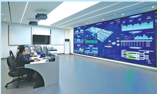
在东方汽轮机有限公司叶片分厂数字集中控制室,工作人员通过系统监测无人车间生产情况。
