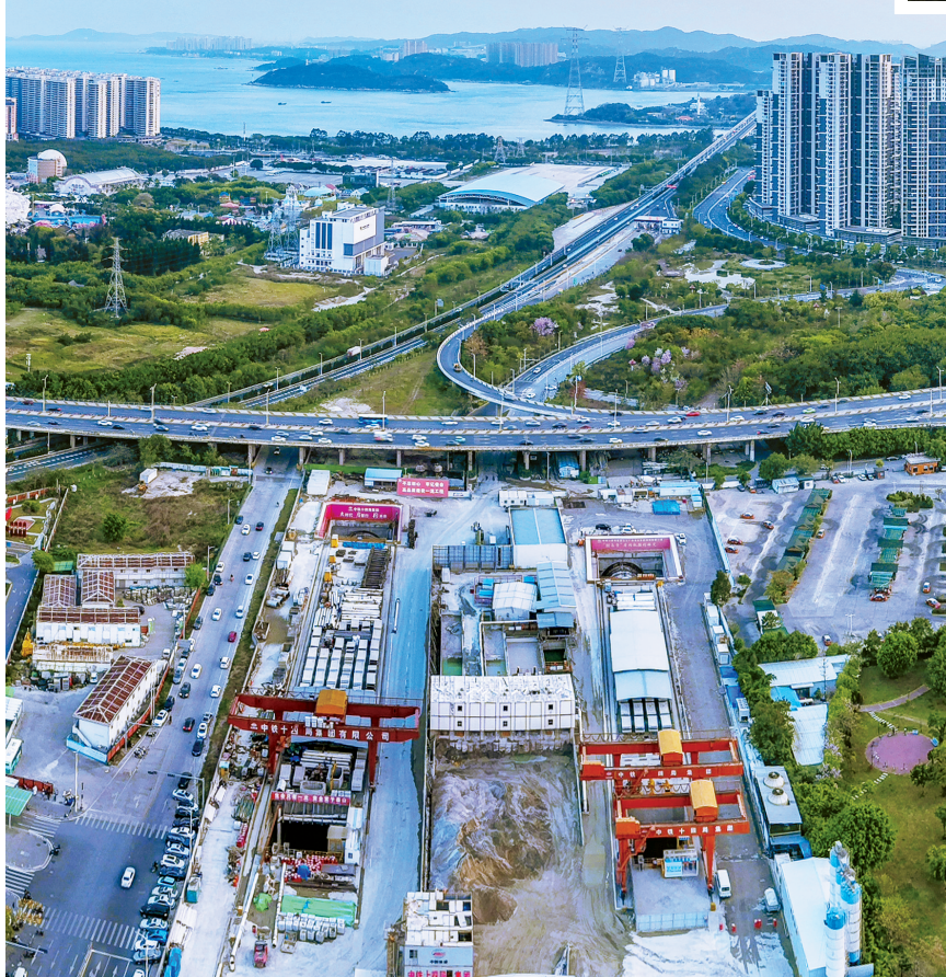
3月25日拍摄的位于汕头湾北端的汕汕高铁汕头湾海底隧道施工现场。新华社发
