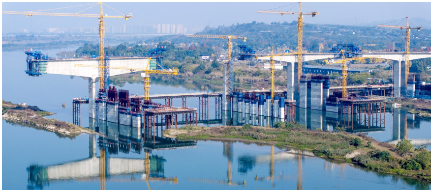
市域(郊)铁路成眉线岷江特大桥施工现场。成都轨道集团供图
