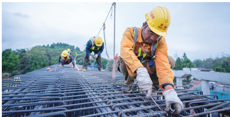
成渝高速扩容项目资阳段施工现场。蜀道集团川高公司供图。
