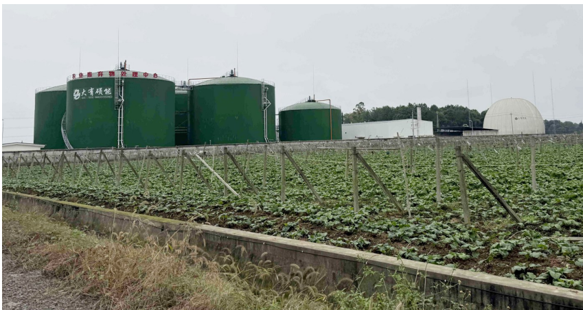
变废为宝的厌氧发酵罐。
