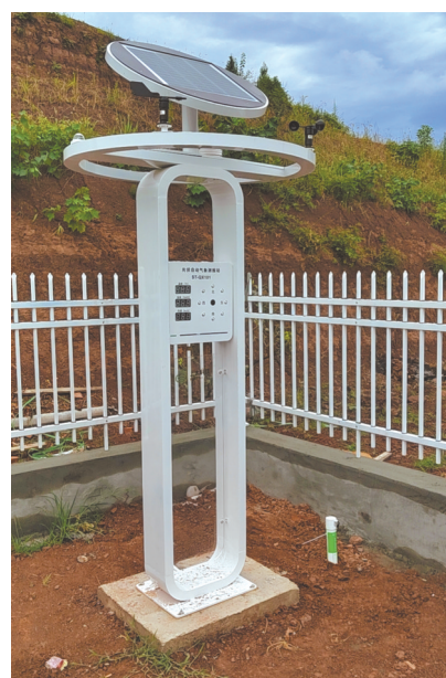
光伏自动气象监测站。
