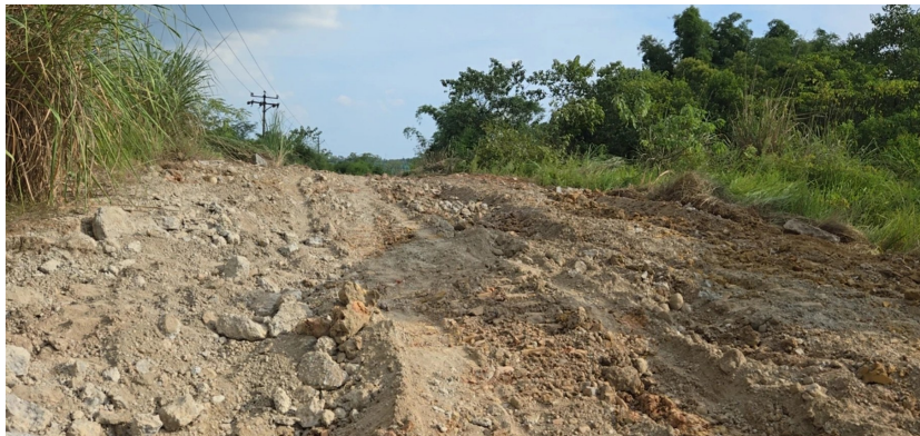
原来的水泥路面被偷后，只剩下坑坑洼洼的路基。图据嘉陵公安
