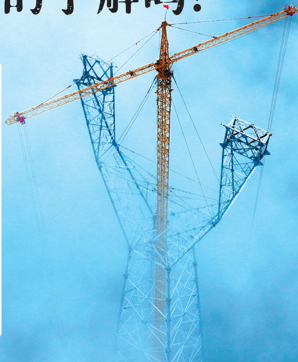
四川最高的输电铁塔高达194.8米。图据国网四川省电力公司
