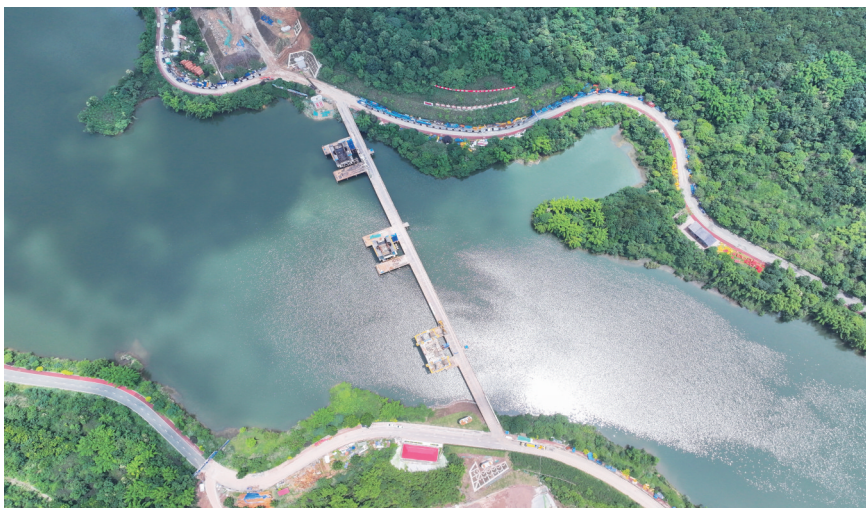
6月5日在重庆市铜梁区拍摄的成渝中线高铁玄天湖大桥建设现场(无人机照片)。新华社发
