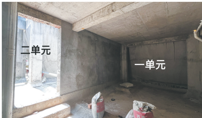
▲ 目前11栋1、2单元顶楼只留一过道，1单元水管被改变。
