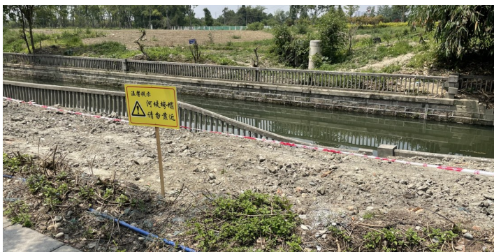
河边立着“河堤垮塌，请勿靠近”警示牌。
