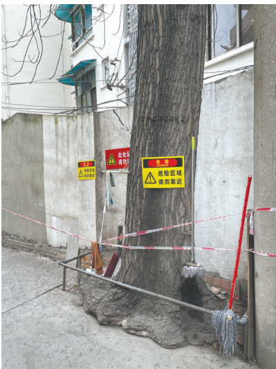
大树紧靠的围墙出现裂缝。
