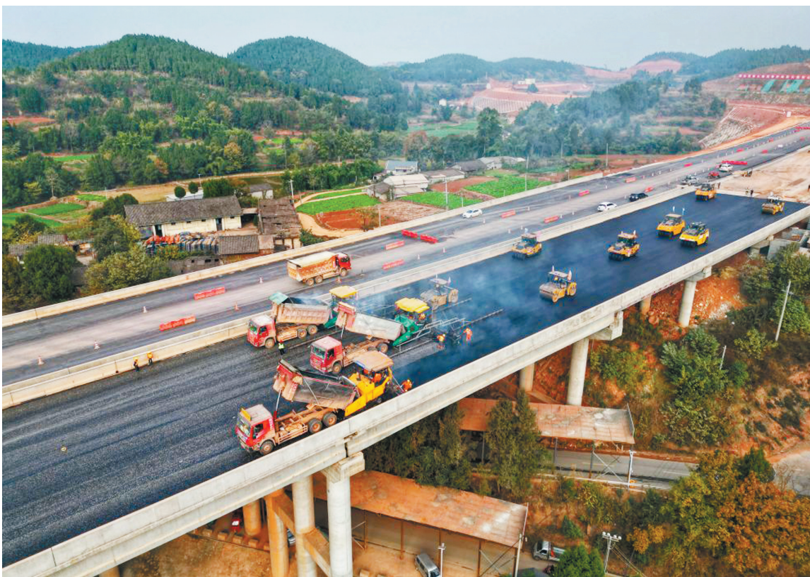
2月19日,G5京昆高速公路绵阳至成都段扩容项目LM2标段正在进行沥青铺设施工。图据新华社客户端
