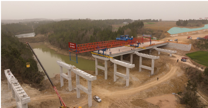
2月20日,广绵扩容项目谢家沟大桥正在架梁。四川省交通运输厅供图
