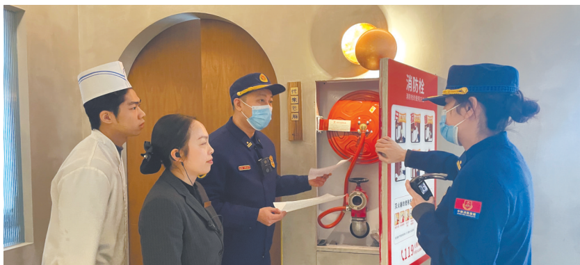
执法人员在成都锦江区一家中餐店的检查中发现消防栓不能正常出水。
