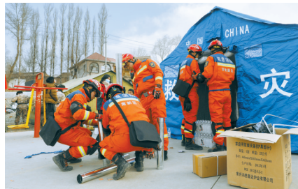
左图：12月19日，在甘肃临夏积石山县大河家镇大河村安置点，消防人员在安装取暖设备。新华社发 右图：川大华西医院医疗救治专家组抵达甘肃省临夏州人民医院开展医疗救治工作。受访者供图
