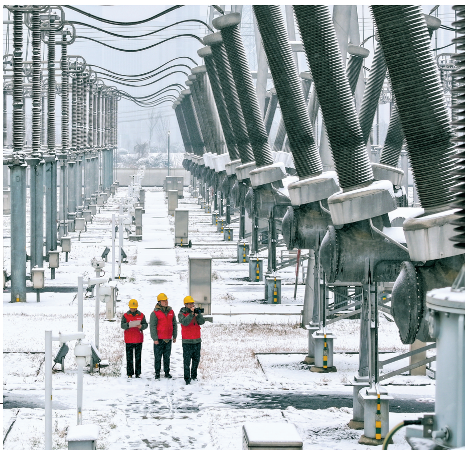
12月18日,在安徽省合肥市500千伏肥西变电站,工作人员在站内巡查。新华社发
