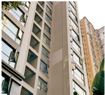
楼栋外墙面脱落痕迹明显。
