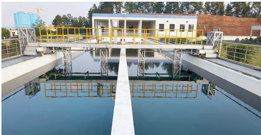
屏山县大乘镇水厂新添的全新一体化净水设备，每天可增加1000立方米净水量。
