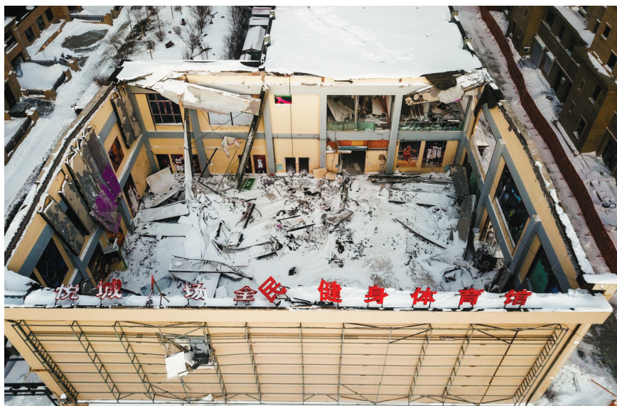
这是11月7日拍摄的发生屋顶坍塌事故的黑龙江省桦南县悦城体育俱乐部。 新华社发
