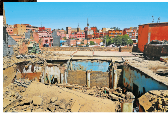
9月10日在摩洛哥震中附近的艾米兹米兹村拍摄的受损建筑。新华社发
