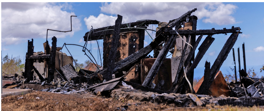
这是8月13日在美国夏威夷州毛伊岛拍摄的受损建筑。新华社发
