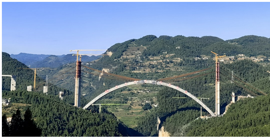
世界最大跨径悬浇拱桥——古金高速水落河特大桥主拱圈顺利完成合龙施工。蜀道集团供图
