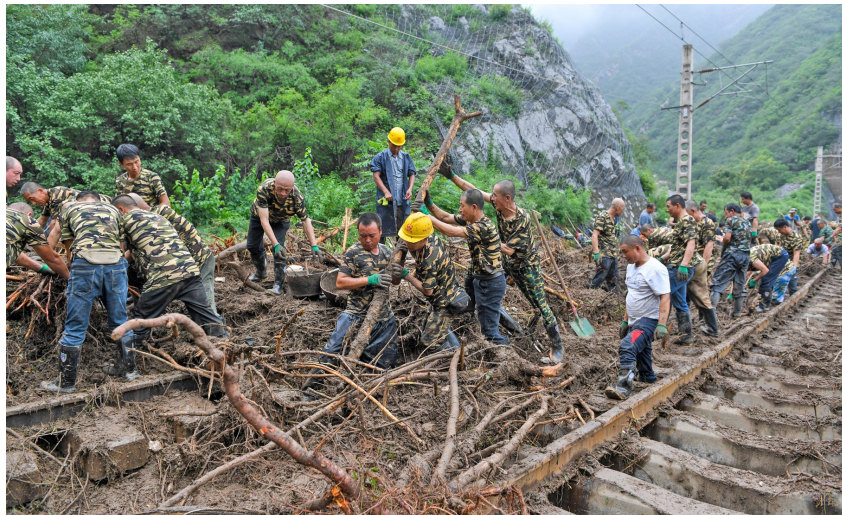
8月1日,在北京市门头沟区水峪嘴村附近一段被阻断的铁路上,中铁六局工作人员在清理轨道上的杂物,全力恢复交通。 新华社发
