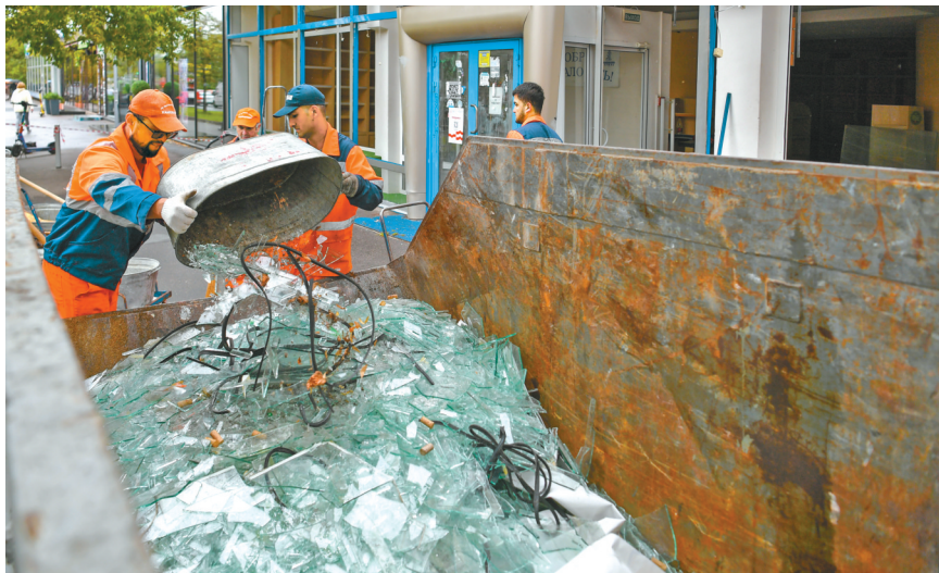
7月24日，在俄罗斯莫斯科，工作人员在遭无人机袭击的建筑现场进行清理工作。 新华社发
