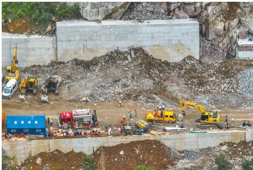
7月9日,救援人员在滑坡现场勘察(无人机照片)。新华社发
