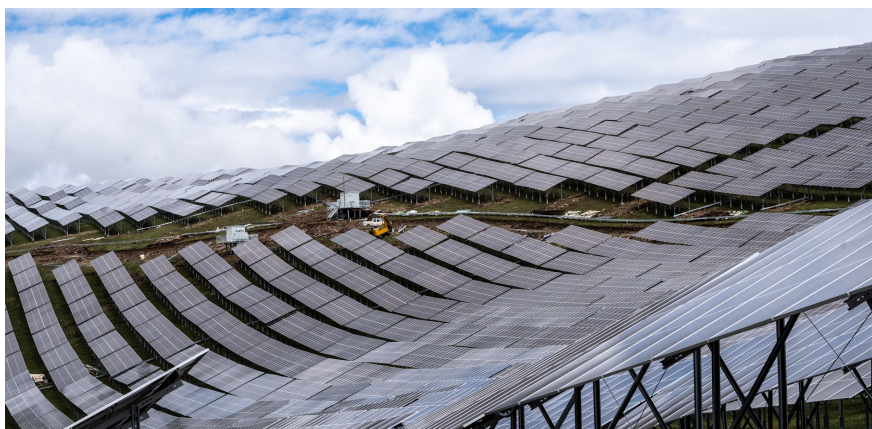
位于甘孜州雅江县柯拉乡的柯拉光伏电站。新华社发
