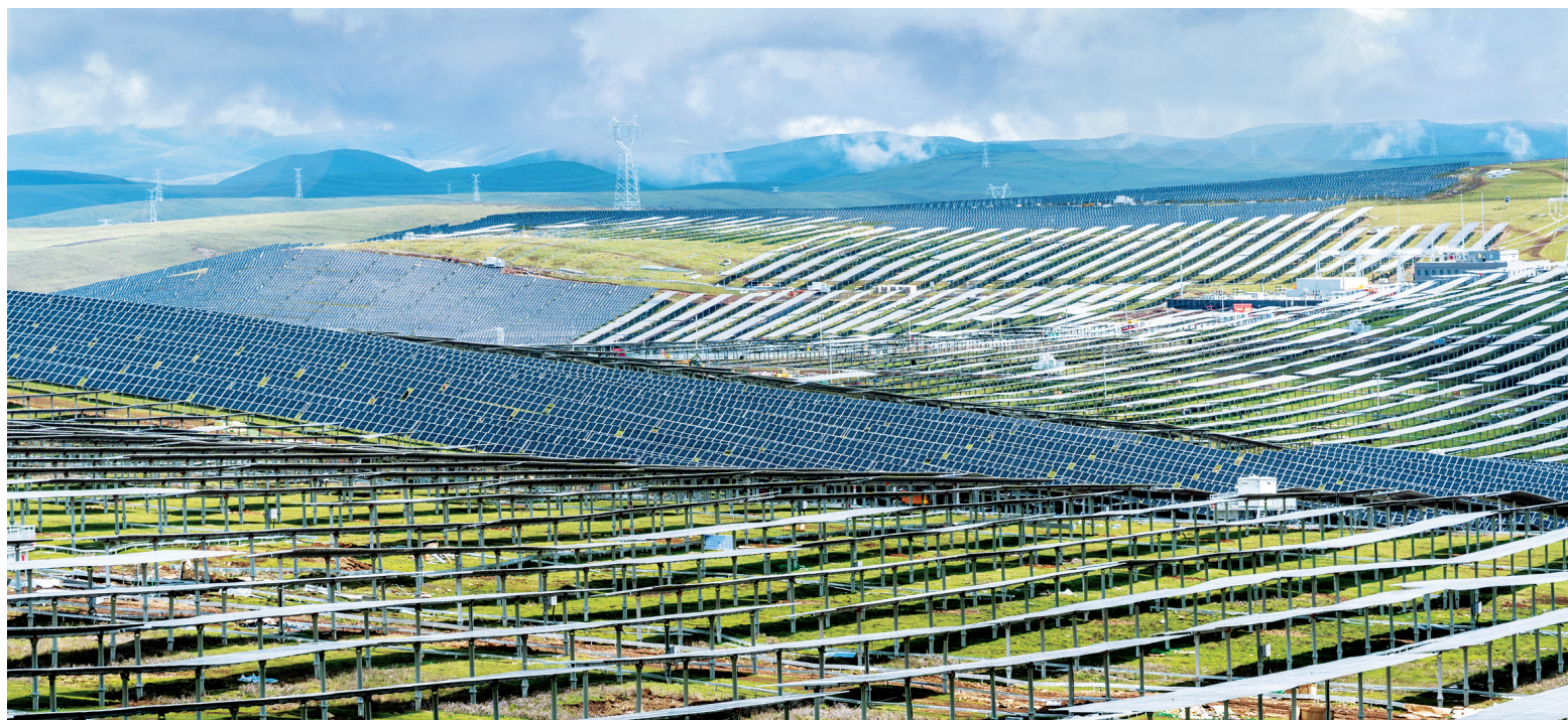
位于四川甘孜藏族自治州雅江县柯拉乡的柯拉光伏电站(6月21日摄)。新华社发
