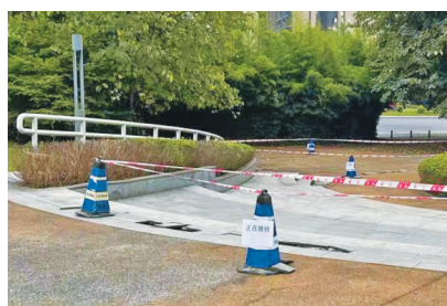
部分破损路面未修补完成。
