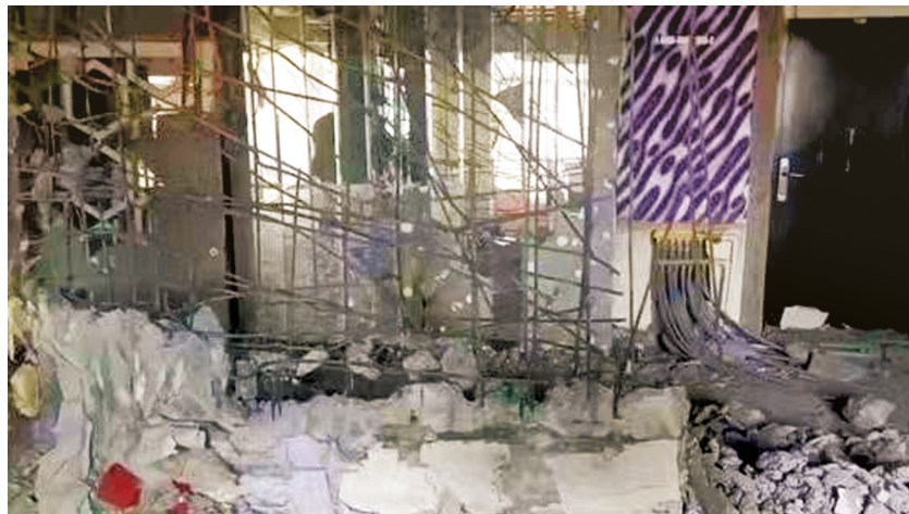
哈尔滨一小区租户私拆承重墙，导致涉事楼栋多个楼层出现墙壁开裂，多户居民被紧急疏散安置。
