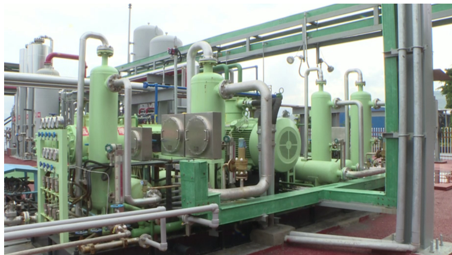
今年7月底完成的攀西首条制氢示范线。
