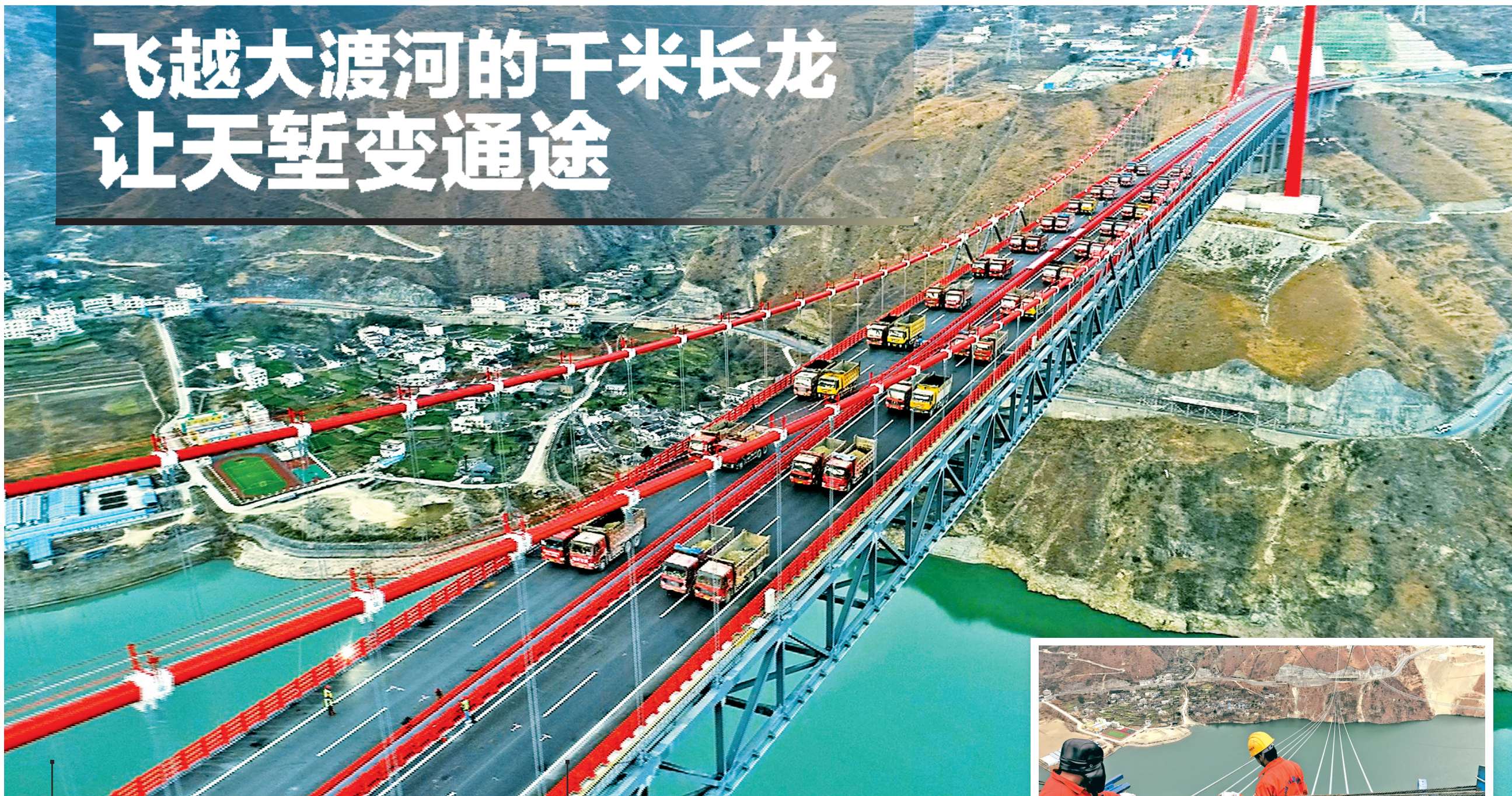
2018年12月,雅康高速公路泸定大渡河大桥进行通车前荷载试验。杨涛摄
