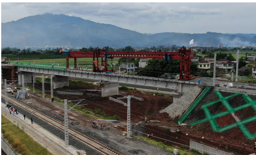
9月20日,新成昆铁路全线T梁架设完成。成昆铁路有限责任公司供图
