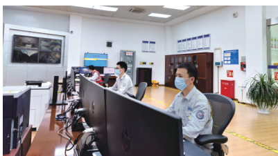
雅砻江公司锦屏电厂员工监控设备安全运行。
