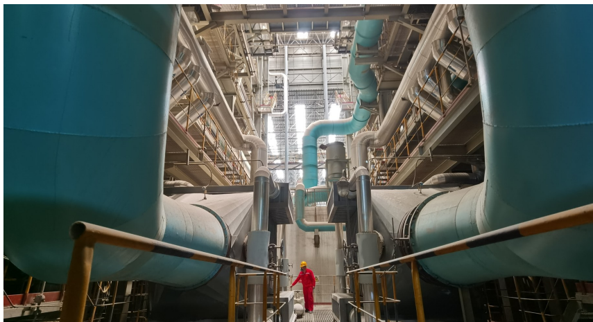
工作人员查看设备运行情况。
