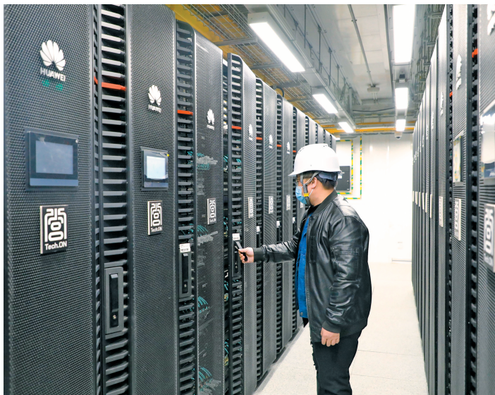
成都智算中心已经投入试运行。
