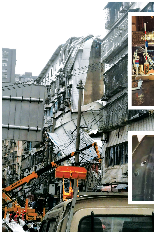
安岳县城东井沟,一处楼顶的彩钢棚被大风掀翻。
