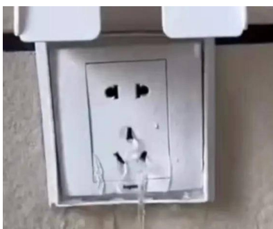
业主家中的插座、开关漏水。
