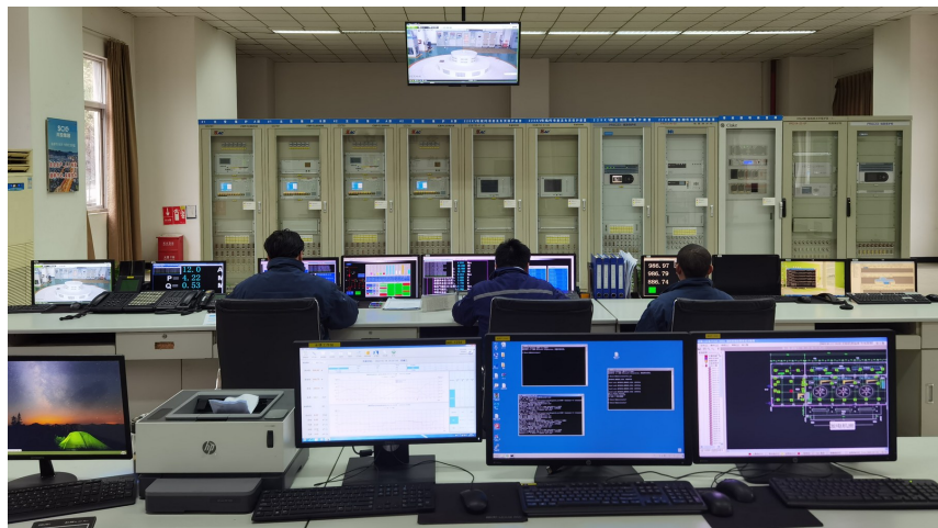
中控室内,工作人员时刻对水情进行监控。
